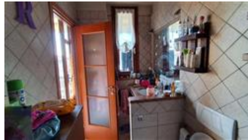
BAGNO - MANCANZA DI ANTIBAGNO
